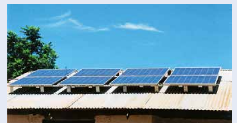
Solaranlage der Klinik Mwangi
